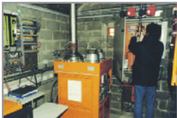
Ronde périodique dans une station
